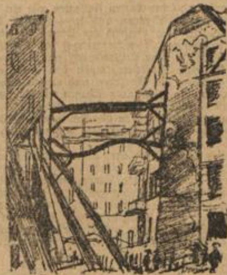
Eiserne I-Stützen haben sich unter dem Druck der sinkenden Häuser wie Drähte gebogen.
