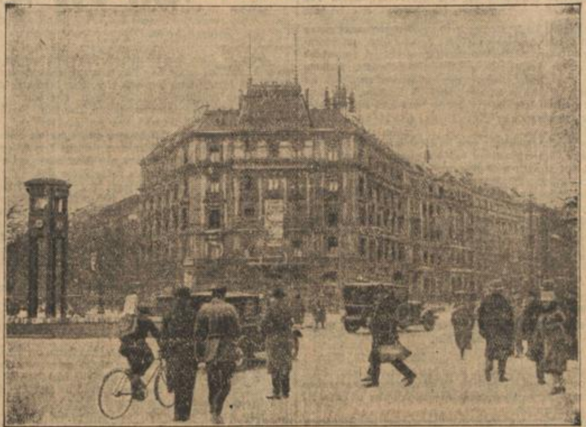
Das frühere Hotel Bellevue am Potsdamer Platz an der Ecke Bellevue- und Friedrich-Ebert-Strasse wird abgerissen, um einem neuen Warenhaus Platz zu machen.
