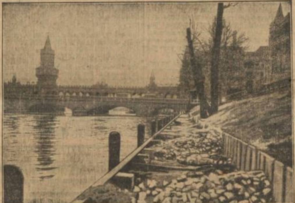
Die Nord-Südbahn-Gesellschaft errichtet zurzeit am Gröbenufer, dicht an der Oberbaumbrücke und dem Schlesischen Tor, einen neuen Anlegesteg für die Personenschiffahrt, der von den Schiffsgesellschaften benutzt werden soll, deren eigene Anlegestegge an der Jannowitzbrücke und am Brandenburger Ufer dem Bau der Spreeunterführung für die Nord-Südbahn weichen mußten.
