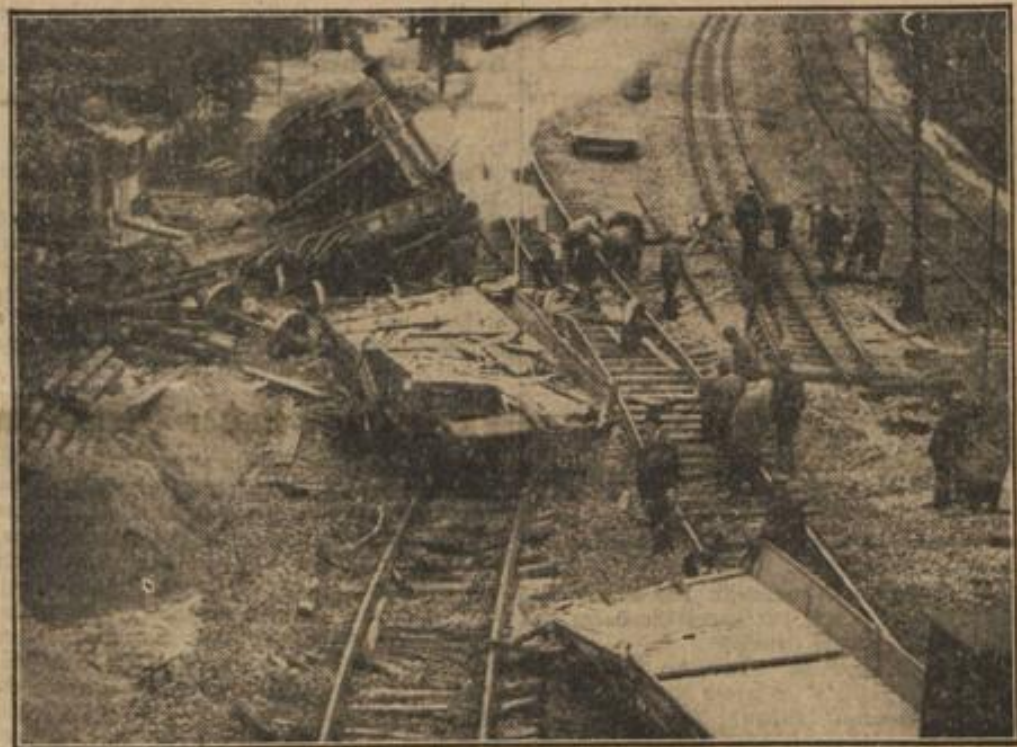
Ein entgleister Arbeitszug. Personen wurden nicht verletzt.
