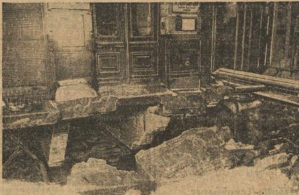
Dies Haus in der Köpenicker Straße mußte am Sonntag von den Bewohnern geräumt werden, da seine Grundmauern unterspült waren.
