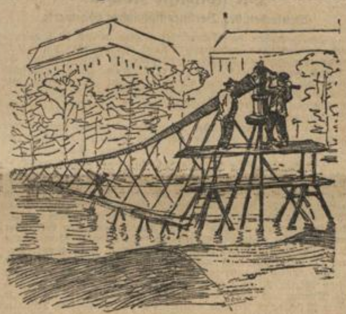
Die Schmelzwasserseen im Schöneberger Stadtpark werden durch diese primitiven Pumpanlagen entleert
